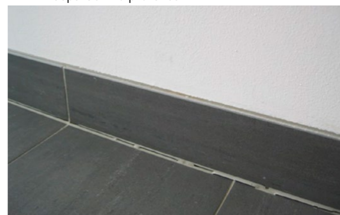
Obr. 26 Potrhaná dilatační spára bez použití separačního provazce
